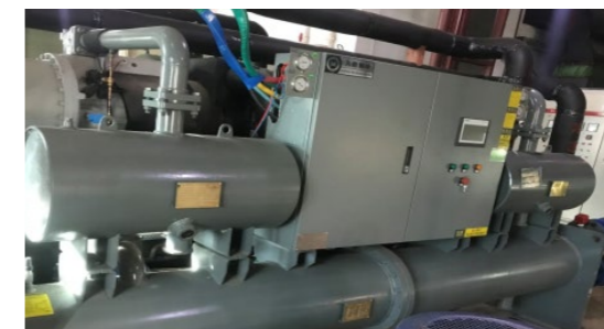
口服液車間雙機頭螺桿冷水機組
